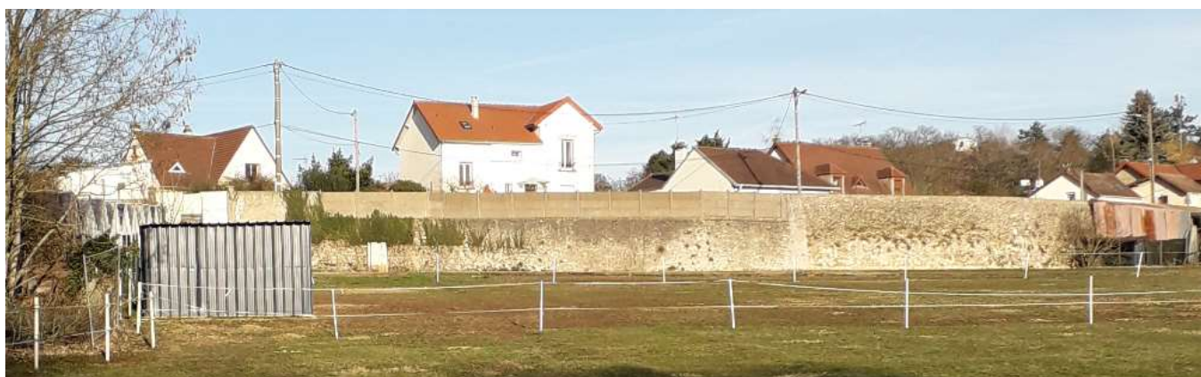
Mur de soutènement existant parcelle AP-147, vue des parcelles riveraines en contrebas
