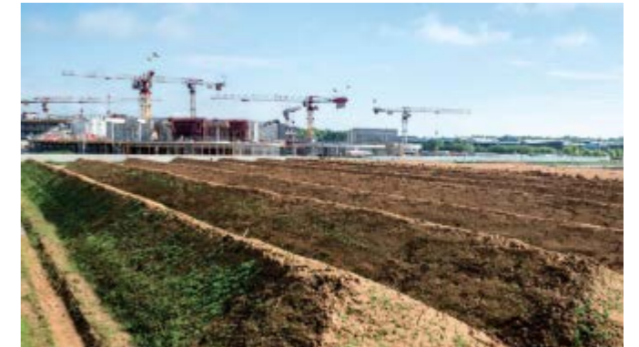
La terre végétale récupérée au cours des chantiers stockée en andains en attendant d'être réutilisée (source EPA Paris-Saclay, 2018)
