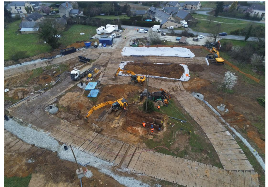
Chantier de dépollution, suite à une fuite causée par des mouvements d'une pelle à chenille. Chantier tiers, non déclaré
