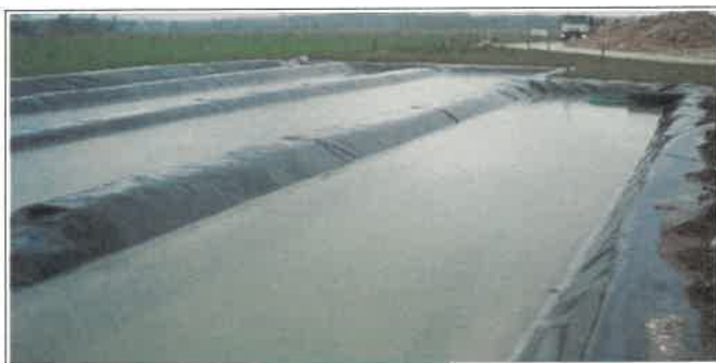
Bassin de rétention provisoire bâché (Source : SYSTRA)
