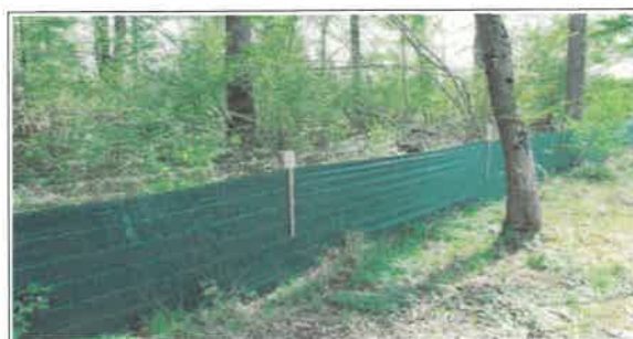
Barrière à batraciens en phase chantier (source : SYSTRA)
