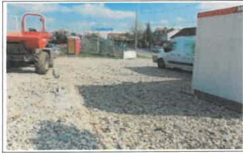
Bâches et pierres concassées au niveau des installations de chantier (Source : SYSTRA)
