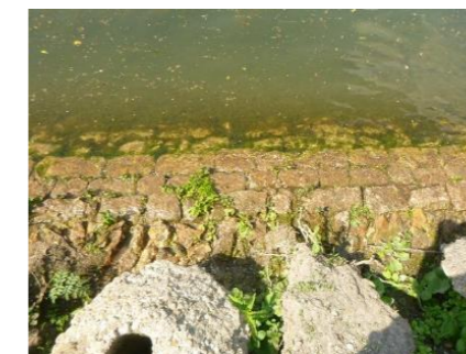
Photo 24 : Colmatage algal observé sur le perré
