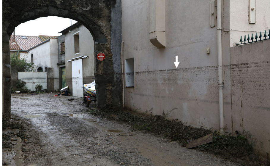
Laisse de crue
